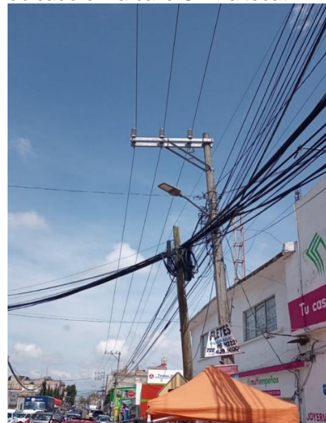
Fotografía 29. Alumbrado público ubicado en la calle Chimaltecatl.
